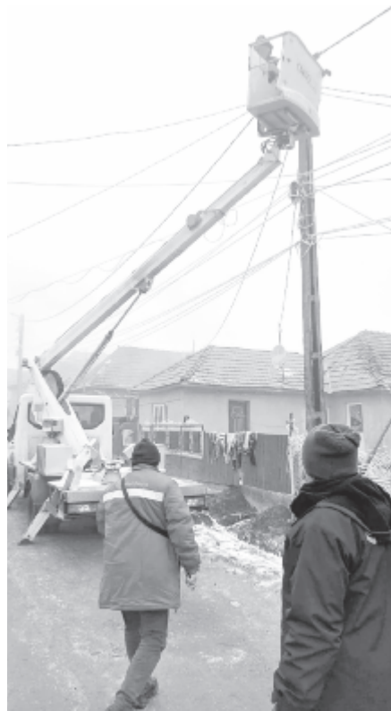
Fotó: Dél-erdélyi Electrica
