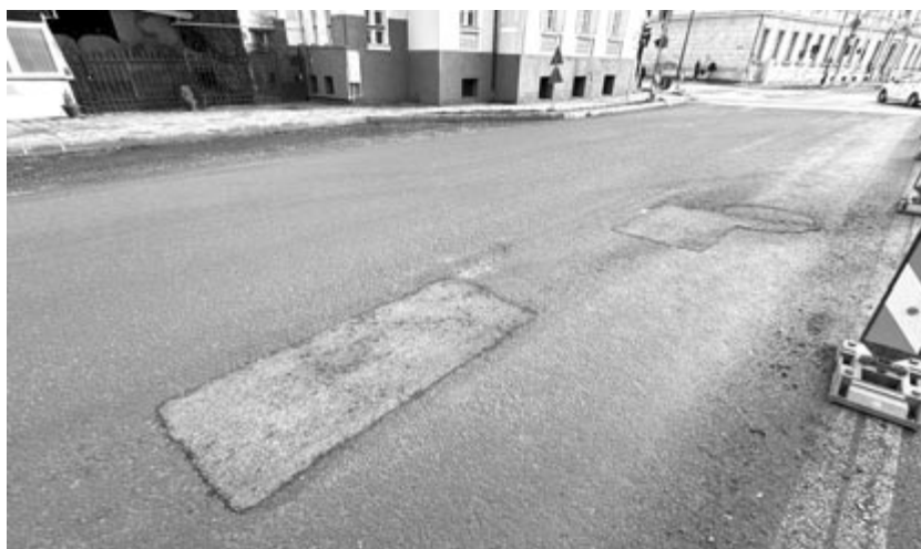
Több lyuk is keletkezett az útburkolaton
